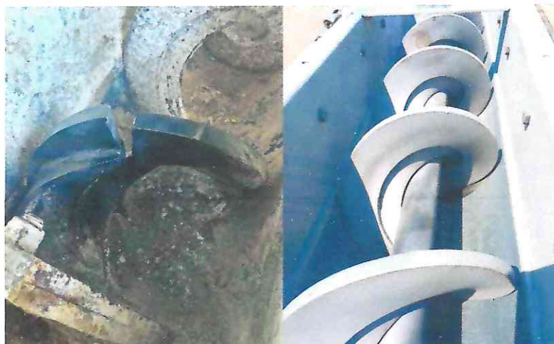
Slika 6. Pukotina na spirali koja je dovela do zastoja u radu pužnog transportera i sanacija spirale kao privremeno rješenje
